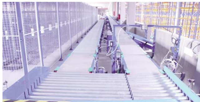
Instalaciones y maquinaria de esta empresa ubicada en Villanueva del Río y Minas, Sevilla
